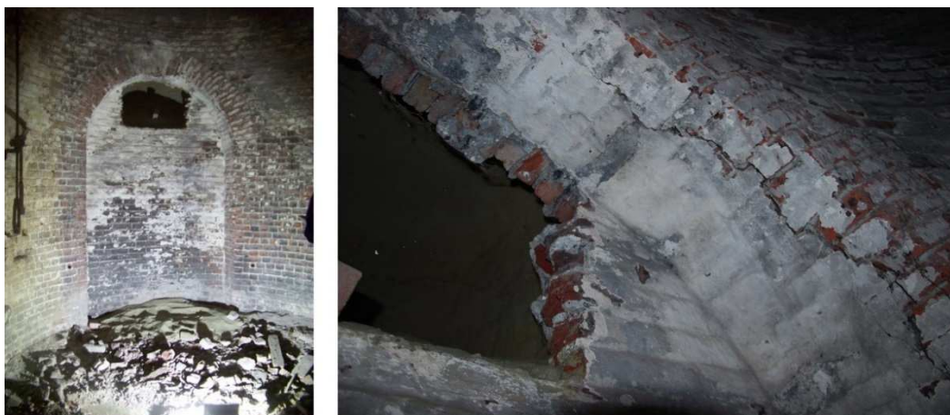
Figuur 29 – (a) Nis op het einde van de ondergrondse tunnel (onder vestingstoren); (b) Detail scheur in boog boven nis (bron: Bressers, 2016)
