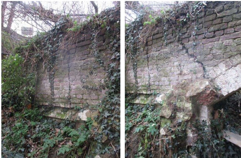
Figuur 23 – (a) Wand tussen de zuidelijke kelder 1 en 2 (zicht vanaf travee 2); (b) Detailfoto scheuren in deze wand; ook de restanten van de aanzet van de gordelboog tussen de gang en zuidelijke kelder 2 is zichtbaar
