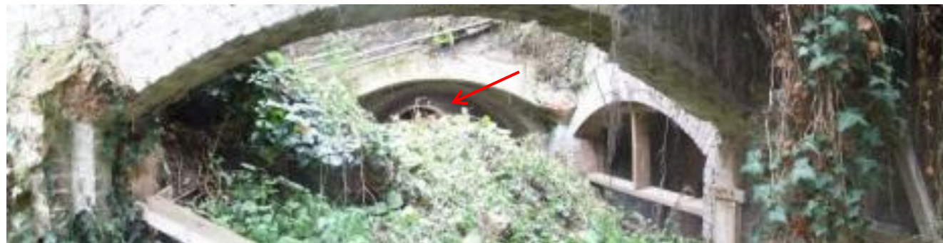
Op de voorgrond bevinden zich de ingestorte keldervertrekken, alleen de scheidingsbogen en de wanden blijven nog over; op de achtergrond (zie pijl) een bevindt zich de toegang tot de tunnel. Tussenin ligt het "puin" van het ingestort bakstenen gewelf en het pakket aarde dat zich boven op bevond.
