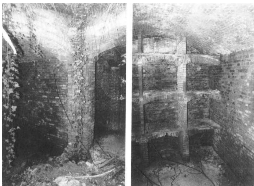
Figuur 3 - Toestand van de kelders in 1993 met zicht vanuit de centrale gang: (a) zicht op de penant tussen de tweede en derde zuidelijke kelder (geteld vanaf de tunnel) met plantengroei van bovenaf (gewelf in dit travee reeds ingestort); (b) zicht op de derde zuidelijke kelder (geteld vanaf de tunnel) met tegen de achterzijde rekken gemetseld zoals in een wijnkelder (bron: Berteloot, 1993)
