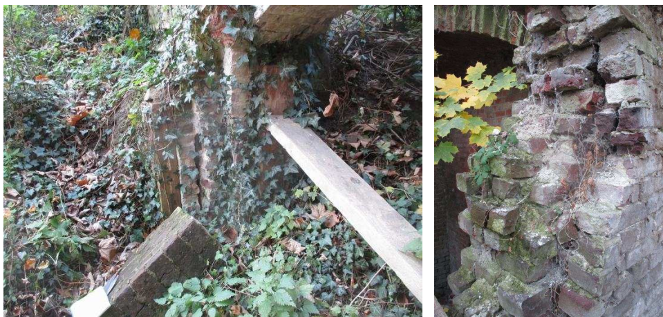
Figuur 26 – Verlies samenhang metselwerk bij (a) wand tussen zuidelijke kelder 1 en 2 en (b) wand tussen noordelijke kelder 2 en 3
