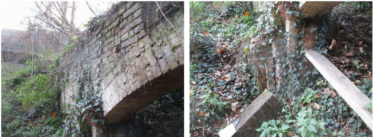
Figuur 18 – (a) Restanten gordelboog gang tussen travee 1 en 2 (zicht vanaf travee 2); (b) Restanten penant onder aanzet gordelboog uit a
