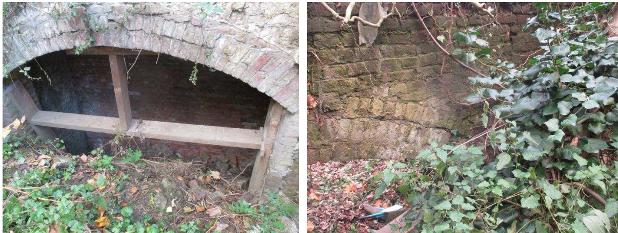
Figuur 27 – Langse scheur in (a) gordelboog tussen centrale gang en noordelijke kelder 1 en (b) gordelboog in gang tussen travee 1 en 2 (zicht vanaf travee 1)
