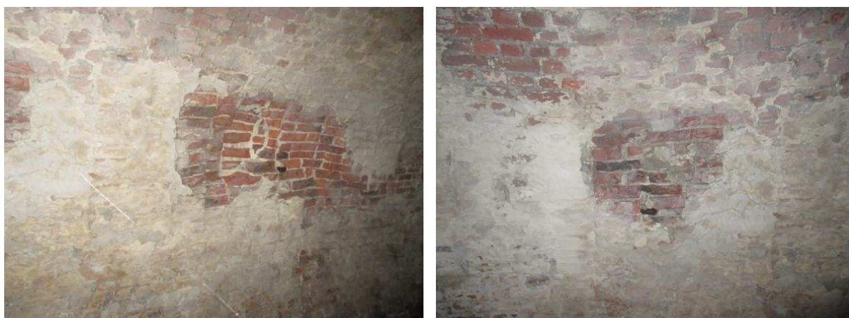
Figuur 30 – (a) Schade tongewelf t.h.v. boom; (b) Schade tongewelf
