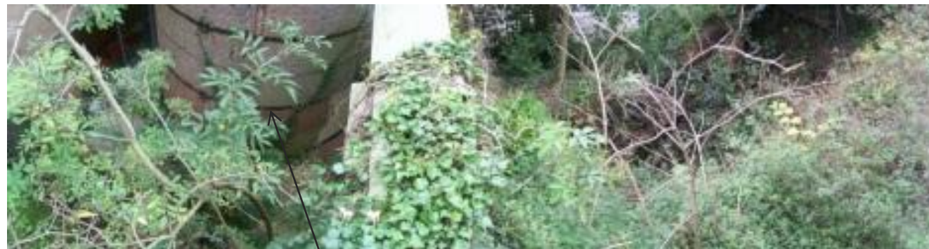
Bovenzicht op de site: links de schoorsteen van de stookinstallatie, in het midden de scheidingsgevel en rechts een zicht op de ingestorte gewelven van de keldervertrekken.
