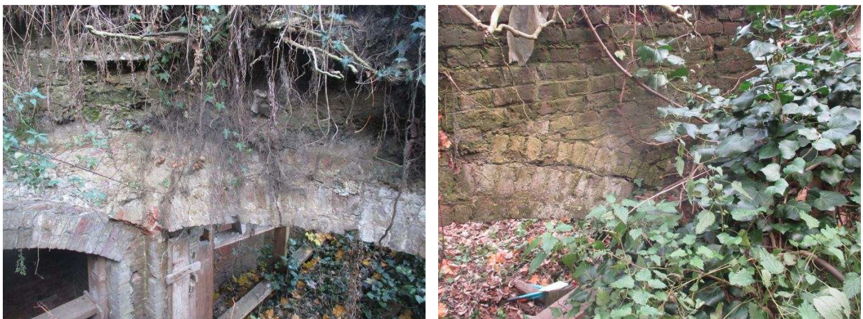
Figuur 21 – (a) Gordelboog gang tussen travee 1 en 2 (zicht vanaf travee 1); (b) Detailfoto scheur in gordelboog gang tussen travee 1 en 2 (zicht vanaf travee 1);
