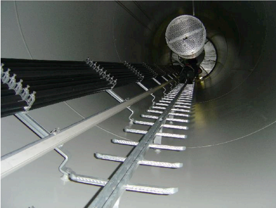
Figuur 4: binnenin in de mast van een grote windturbine (Foto: J. Peuteman)
