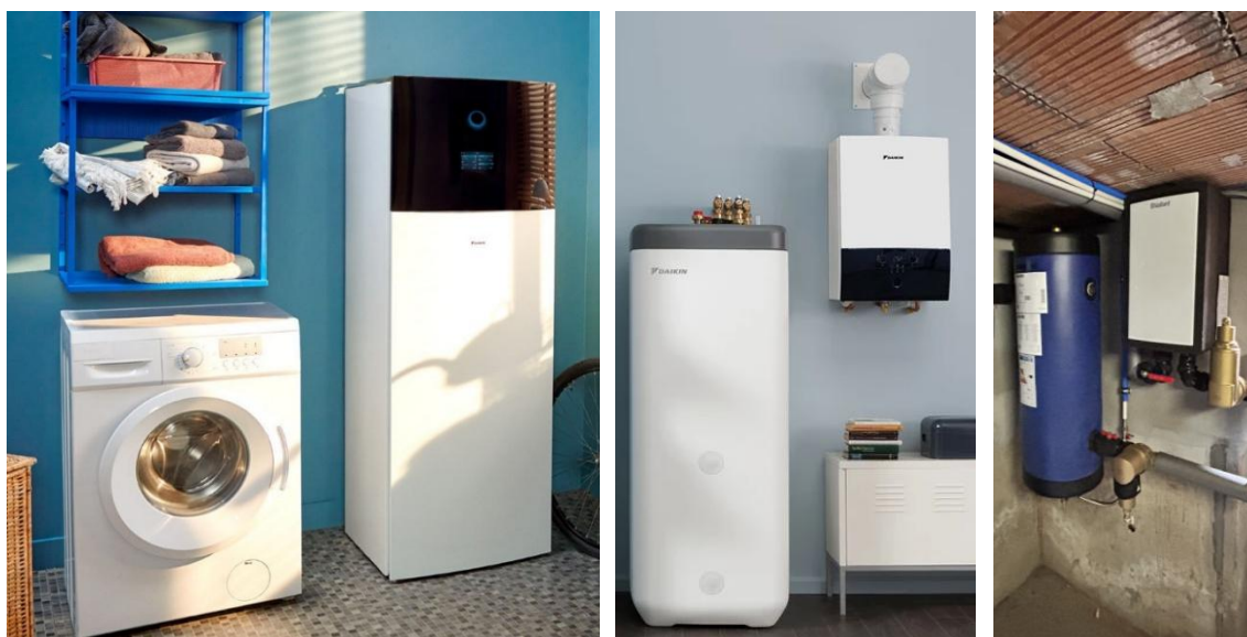
Figuur 36 Binnenunit met geïntegreerd sanitair warm water vat (links), binnenunit en apart sanitair warm water vat (midden) en extra buffervat voor minimale waterinhoud (rechts).
